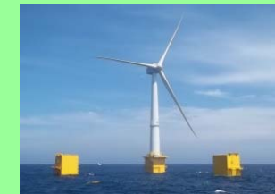
7MW浮体式風車 「ふくしま新風」
